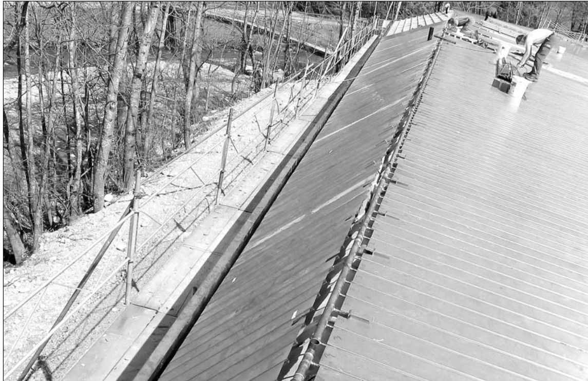
Die Montage des Energiedaches ist eine Präzisionsarbeit, denn die Kupfereindeckung dient gleichzeitig als dichtes Dach und als Absorberfläche für die Wassererwärmung mit Sonnenenergie. Das System hat sich bereits an mehreren Orten bewährt, so in Teufen und Vaduz. (Bild: Hubert Müggler)
