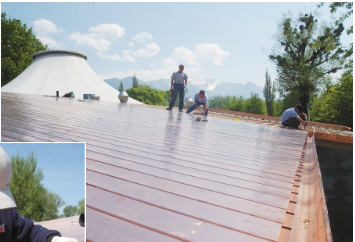
Dach als Energiequelle zur Warmwasserproduktion: Das Energiedach besteht aus FS- Profilen. (Objekt Schwimmbad Vaduz)
