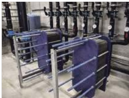
Die Wärmetauscher, die sich unter der Tribüne befinden. (Bild: cp)
